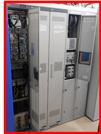
基地局無線装置
