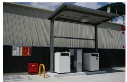
3月 自家用給油取扱所整備 (消防本部・中消防署、南消防署)
